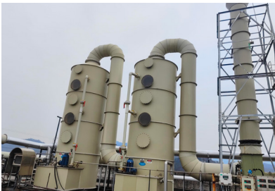
尾气吸收塔采用多级喷淋吸收，确保废气处理去除率超过 95%
