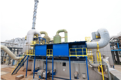
废气蓄热焚烧炉 RTO，废气处理效率达 99%
