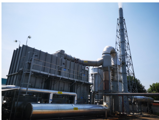
废气处理 RTO 装置
