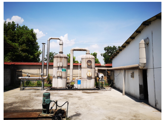
危废暂废气收集及处理
