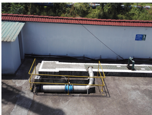
污水站标排口
