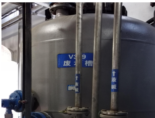
高浓废水收集罐
