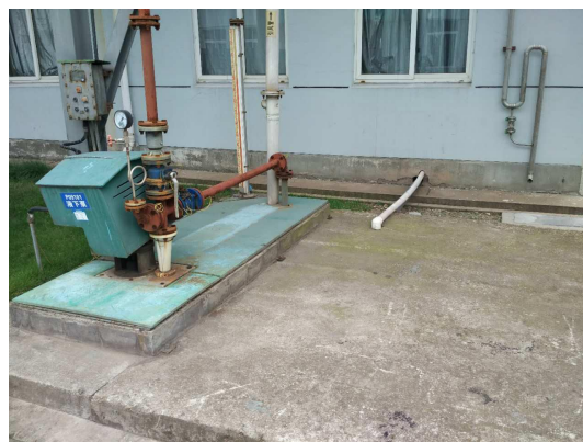
车间废水收集池
