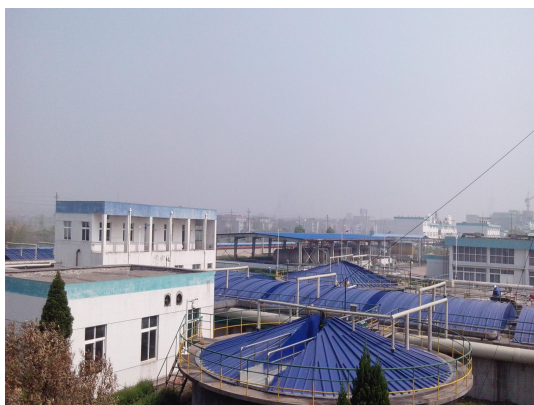
厂区污水处理站
